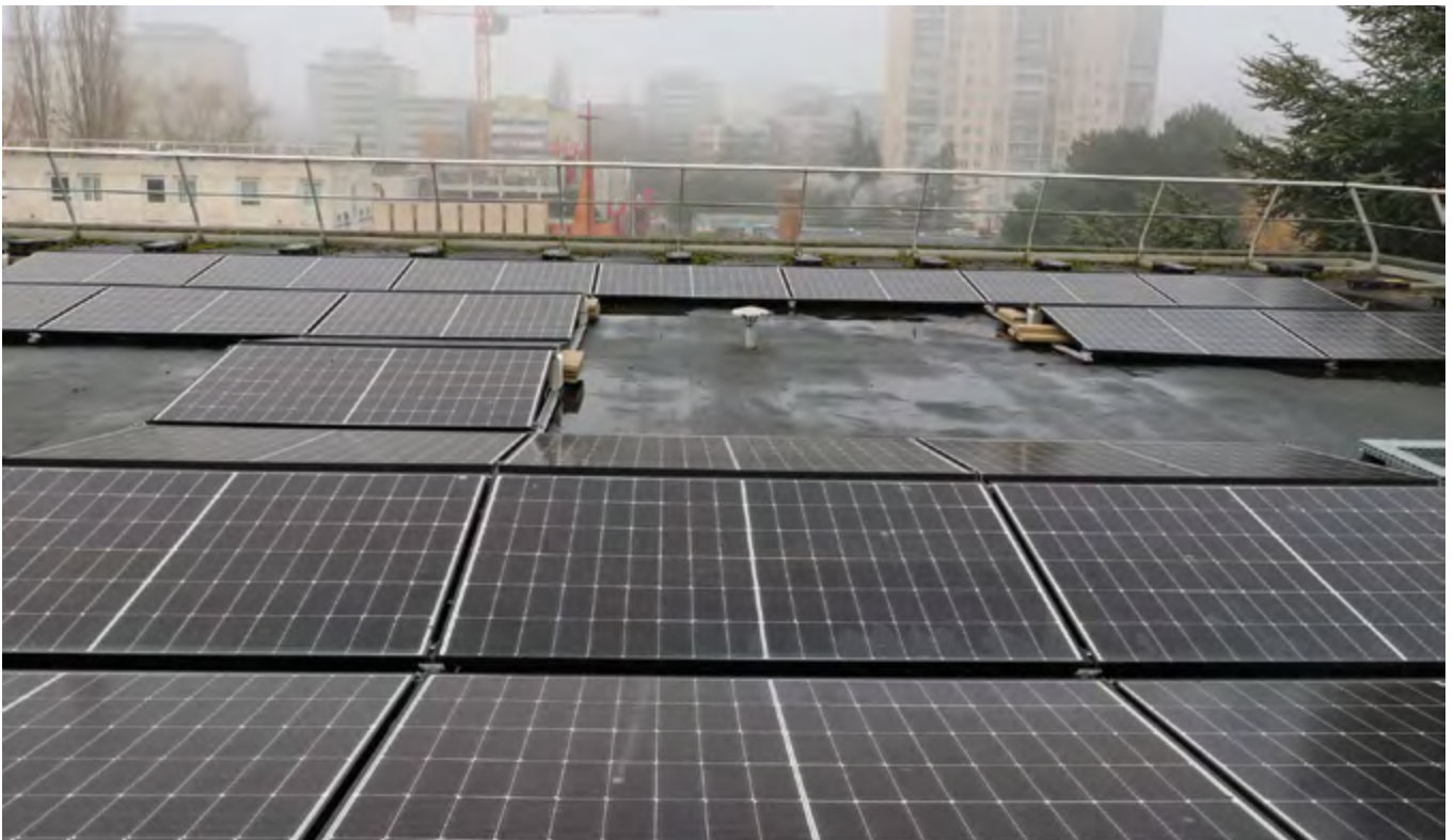
Les toits de l'école Jacques-Prévert sont désormais recouverts de panneaux solaires.
