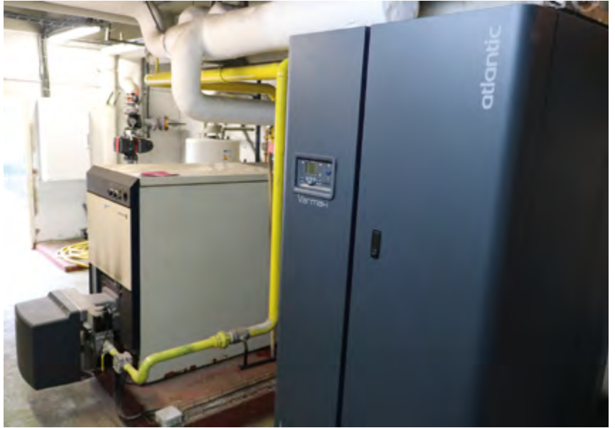
La nouvelle chaudière du groupe scolaire Jacques Prévert. Au second plan, l'ancienne chaudière maintenue en cas de besoin.
